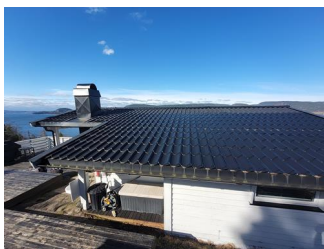
Tekking (med tilhørende beslag) - Yttertaktekking.
