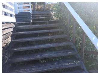
Rekkverkshøyde og lysåpninger - Trapp ved terrasse ved anneks.
