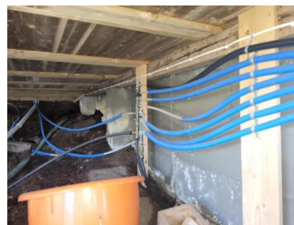
Fordelerskap og fordelerstammer - Fordelerstammer for rør i rør.
