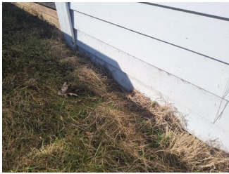
Ytterkledning (fasademateriale, vannbord, utvendig listverk, o.l.) - Eksempel på liten avstand mellom utvendig kledning og terreng.
