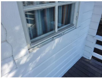
Vinduer, dører og porter - Manglende vannbrett under vindu.
