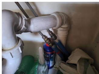
Vannrør - Vannrør uten plugg mot varerør.
