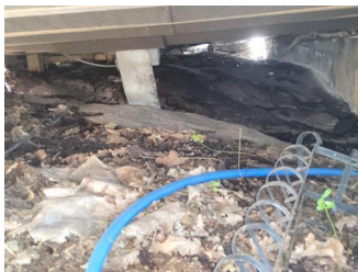
Søyler og pilarer - Skjevheter i pilarer.
