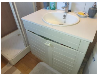
Sanitærutstyr og innredning - Innredning.
