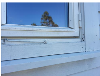
Vinduer og omramming - Eksempel på vindu med lite fagmessig god utførelse av belistning i underkant av vindu.
