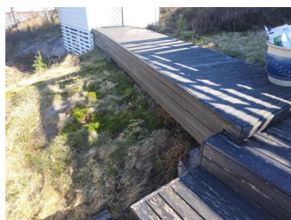
Rekkverkshøyde og lysåpninger - Manglende rekkverk på gangbane til utebod.
