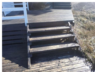
Rekkverkshøyde og lysåpninger - Trapp mellom terrassenivå ved anneks.
