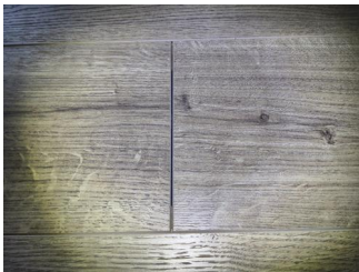
Overflate gulv - Glippe i gulv
