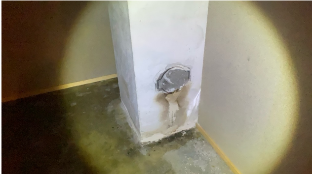
Sotskjolder under feieluke
