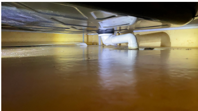
Sluk under dusjkabinett
