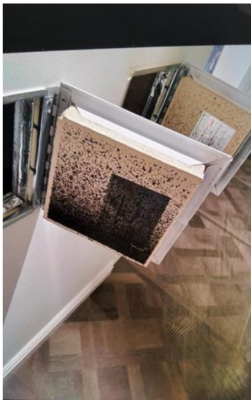
Ildsteder / skorsteiner innvendig. (Omfatter ikke funksjonalitet og innvendig pipeløp) - ["Feieluker/sotluker"]
