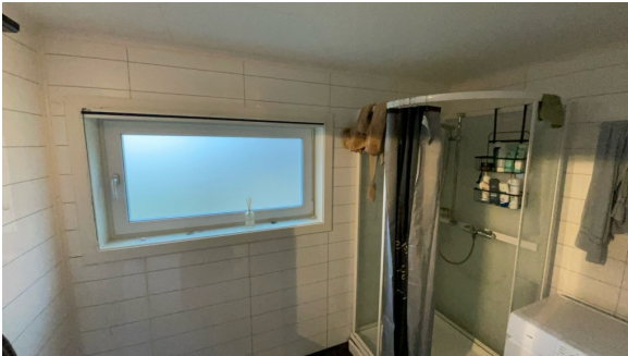
Vindu er plassert i våtsone like utenfor dusjkabinettet.
