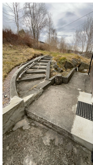
Oversikt trapp på oversiden som har sprekker i trinn
