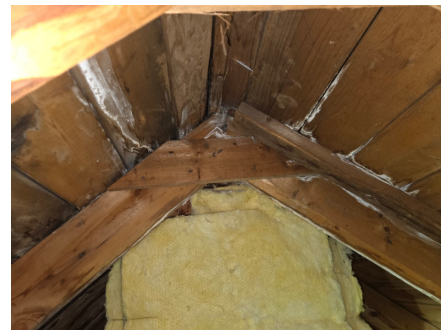
Eldre fuktmerker i underpanel ved pipe, ingen fukt målt ved befaringen
