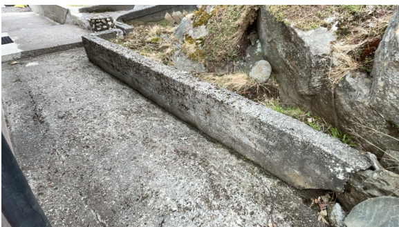
Støttemur i betong er løsnet fra hjørne mot trapp og er da presset noe frem.
