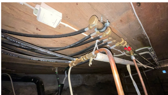
Fordelingskolbe er montert i himling i kjeller
