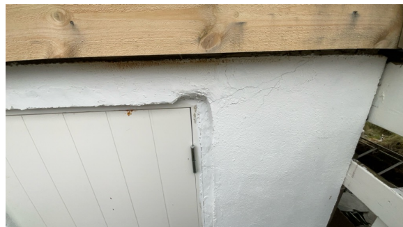
Små sprekker i puss/grunnmur ved kjellerdør
