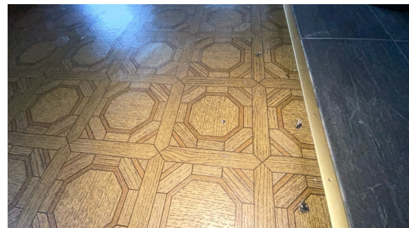
Brennmerker i belegg foran vedovn og det er synlige bølger på belegget som viser at belegget ikke er tilstrekkelig festet mot underlaget.
