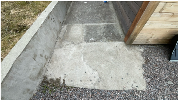
Det er registrert sprekk i betongdekket ovenfor boligen.
