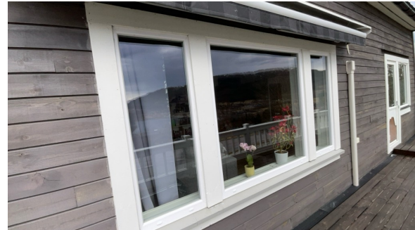
Stuevindu er montert uten vannbrett/beslag over vindu. Markise med beslag inn på vegg som er med på å sikre at vann går ut fra veggen
