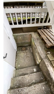
Oversikt trapp til kjeller som har noe sprekker i støttemur og slitasje i trinn
