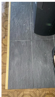
Flis på gulv under ildsted har bom i flis/skifer (Løse flis) og riss/slitte fuger
