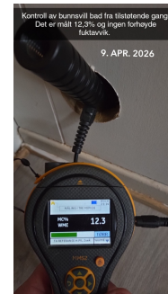
Kontroll av bunnsvill fra tilstøtende gang. Det er målt 12,3% og ingen forhøyde fuktavvik.
