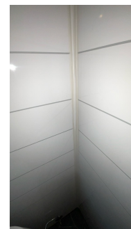
I hjørner på våtromsplater er det brukt trelister som er malt og fuget. Det er ikke i henhold til monteringsanvisning på platene.
