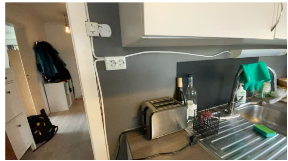
Kabel på kjøkken er ikke festet
