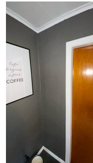
Det er lagt malt tapet utenpå pipeløpet på kjøkkenet.
