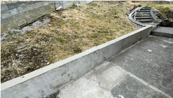
Sprekker i støttemur av lettklinkerblokk
