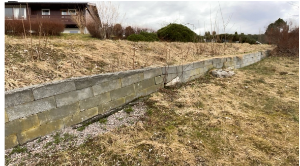
Støttemur i betongstein har noe sprekker og er ujevnt montert
