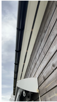
Synlig luftespalte i raftekasse ved overgang tak/vegg
