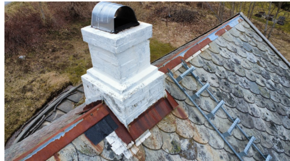
Synlig rust på møne og deler av nedre del av pipebeslag. Tilgang til pipe via takstige
