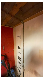
Hovedvannsrør i lagerrom 2 er uisolert og videre inn i lagerrom 3
