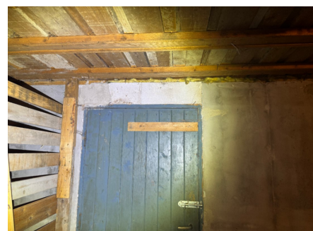
Gammel dør i grunnmur
