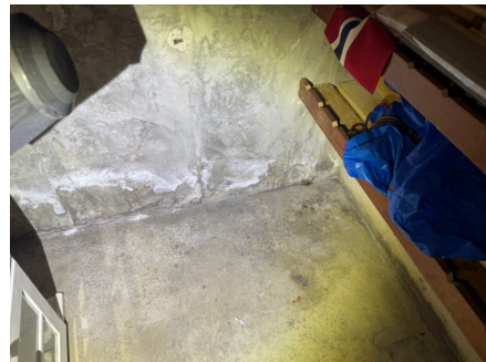
Fukt i nedre del av grunnmur
