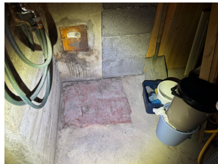
Rustete sotluke i kjeller med rennemerker under
