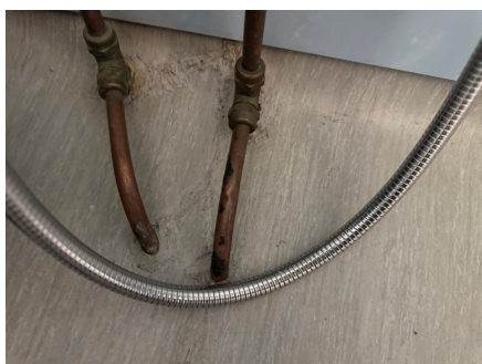
Ufagmessig tetting rundt rørgjennomføringer. Dette området må påregnes som utett på gulv.
