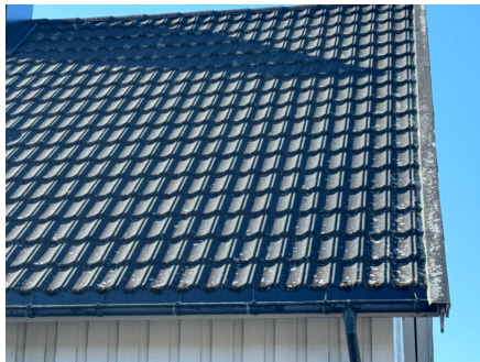
Noe behov for rengjøring av takoverflater
