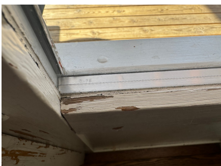
Slitasje i terrassedør
