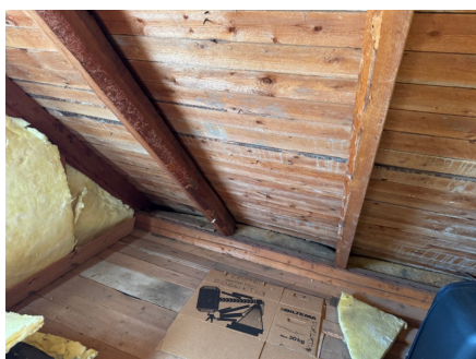
Isolasjon helt opptil undertak i nedre del som kan medføre varmegjennomslag vinterstid
