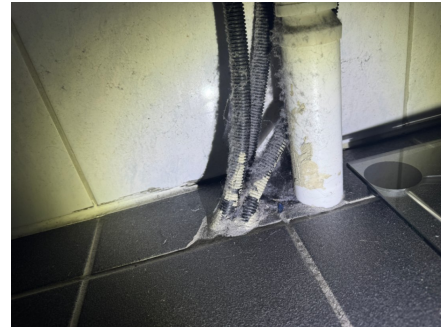
Ufagmessig utførelse rundt rørgjennomføring
