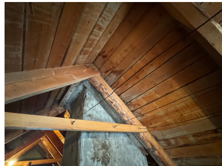
Fuktmerker rundt pipe
