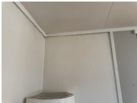
Sprekker/riss i overflater
