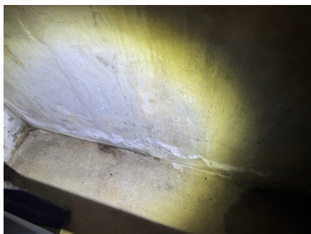
Fukt i nedre del av grunnmur
