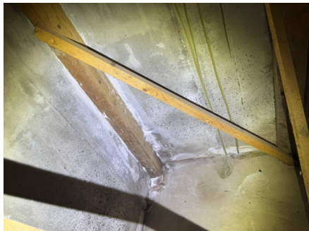
Fukt i nedre del av grunnmur
