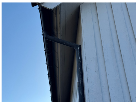
Ingen luftespalte i nedre del av takkonstruksjon
