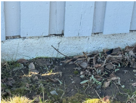
Setningssprekk i leca ved inngang
