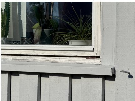
Slitasje/småskader i vinduer
