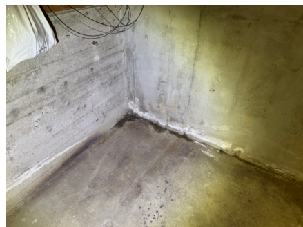
Fukt i nedre del av grunnmur
