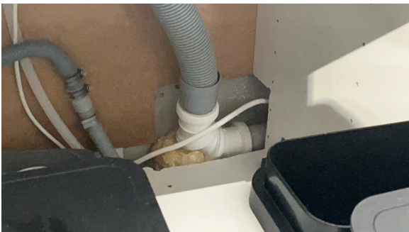
Avløpsrør under kjøkken er festet med byggeskum.
