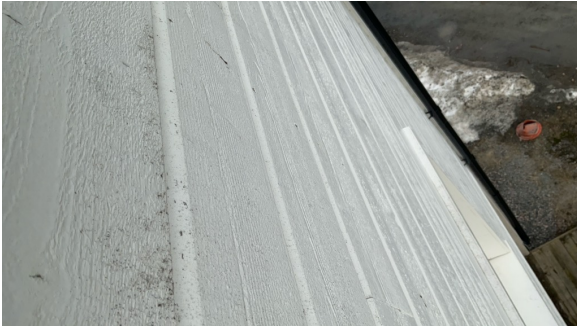
Svertesopp/misfarging på kledning enkelte steder.
