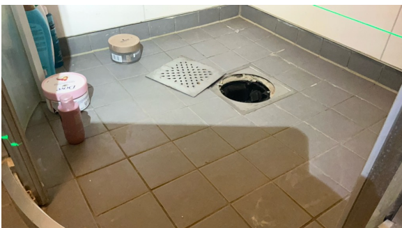
Lokalt fall i dusjsone, tett terskel omkring dusjhjørnet.
