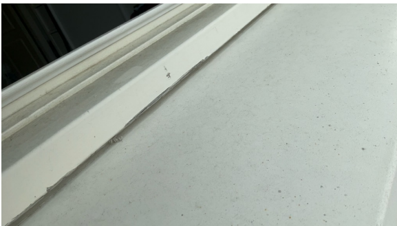
Soveromsvindu har noe behov for vedlikehold. Slitte pakninger.
