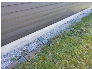
Grunnmur og fundament - Eksempel på fuktmerker på grunnmur.
