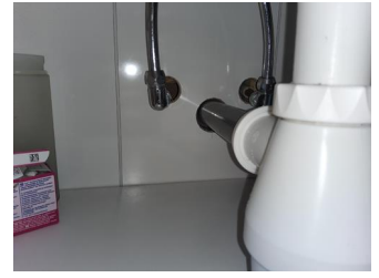
Vannrettet sjikt / membran i gulv og vegger - Utette rørgjennomføringer i vegg under servant.
