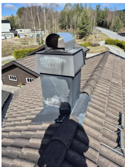
Tekking (med tilhørende beslag) - Slitasje på pipebeslag.
