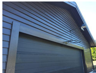
Vinduer, dører og porter - Manglende vannbrett over garasjeport.
