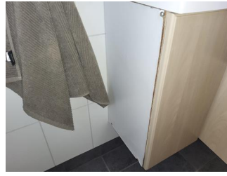
Sanitærutstyr og innredning - Eksempel på svelleskader på innredning.
