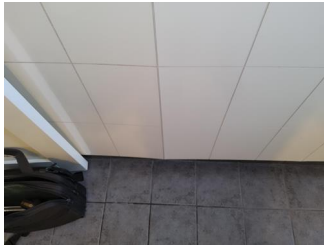
Overflater vegger - Eksempel på løse baderomsplater.
