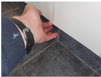
Overflater vegger - Eksempel på løse baderomsplater.
