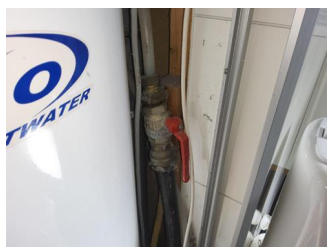
Innvendig stoppekran - Innvendig stoppekran.
