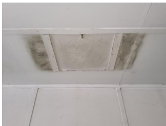
Innvendige forhold - Fuktskjolder ved luke til kryploft.
