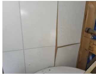
Overflater vegger - Eksempel på skader i baderomsplater.
