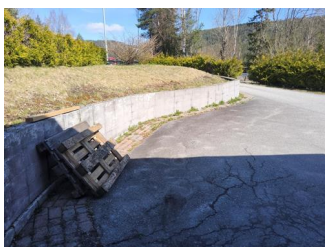
Rekkerkshøyde og lysåpninger - Støttemur ved innkjørsel/gårdsplass med manglende rekkverk på toppen.
