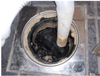
Avløp (inkl. sluk) - Sluk under dusjkabinett.
