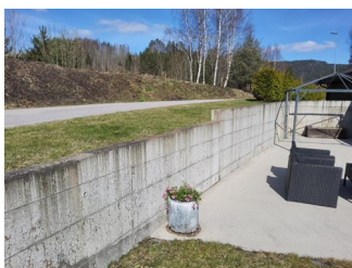
Rekkerkshøyde og lysåpninger - Manglende rekkverk på topp av støttemur langs vei.
