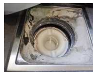
Avløp (inkl. sluk) - Sluk i toalettrom/teknisk rom.
