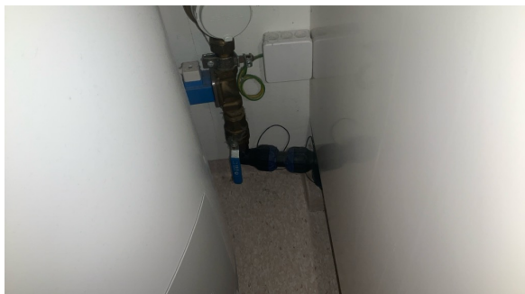
Stoppekran er plassert på teknisk rom.
