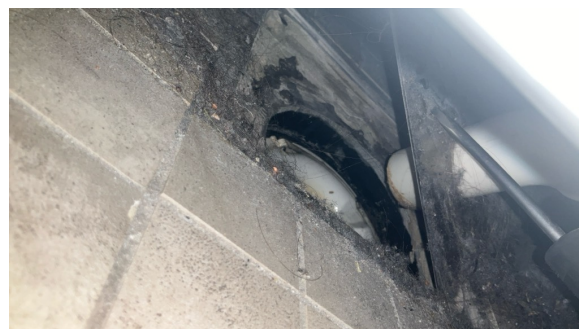
Bi-sluk under badekar: Plastsluk. Synlig membran/ slukmansjett i sluket. Ukjent type membran/tettesjikt.
