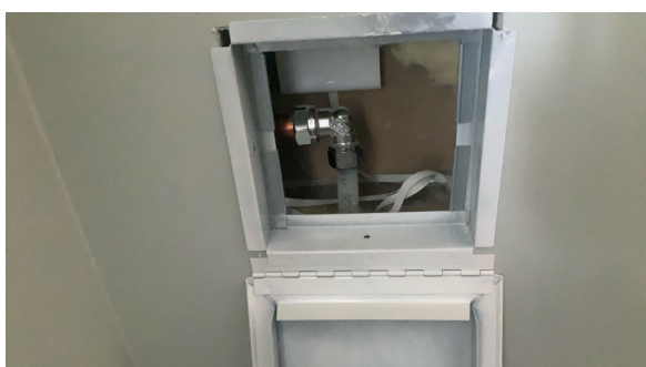
Inspeksjonsluke for koblingspunkt til utekran med vannsensor på soverom 2.
