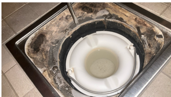
Sluk i dusjsone: Plastsluk. Synlig membran/ slukmansjett i sluket. Ukjent type membran/tettesjikt.
