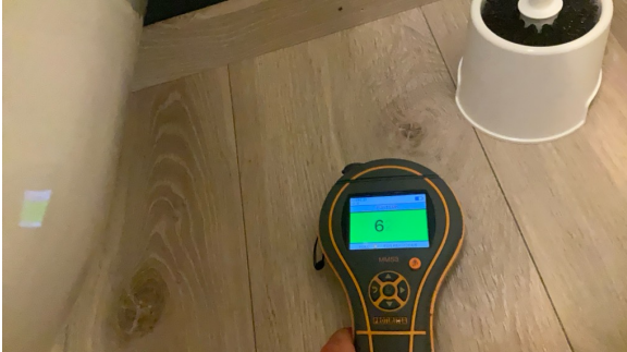
Gulv: Ved bruk av fuktindikator på utsatte steder registrerte jeg ingen unormale verdier.
