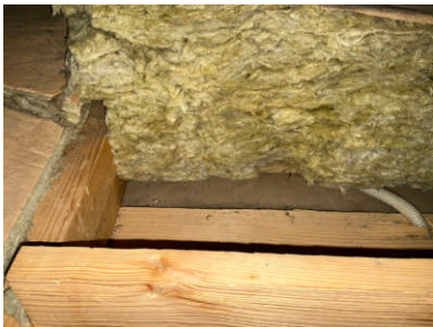
Manglende isolasjon av undergurt.
