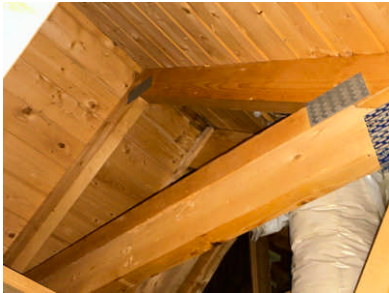
Fuktmerker i taktro.
