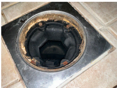
Eldre plastsluk i dusjsone.
