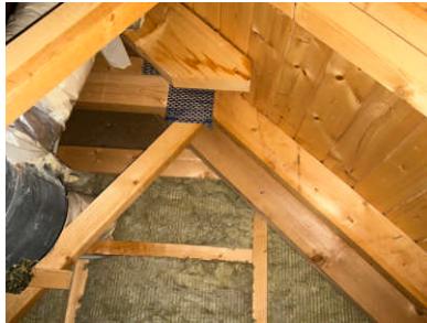
Fuktmerker i taktro og taksperre.
