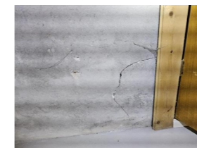
Overflate vegg - Sprekk i grunnmur.
