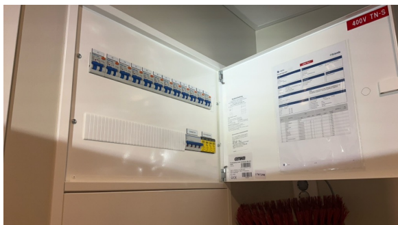
Sikringskap i teknisk rom.
