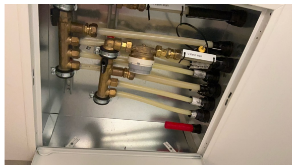
Fordelerskap i himling bad.
