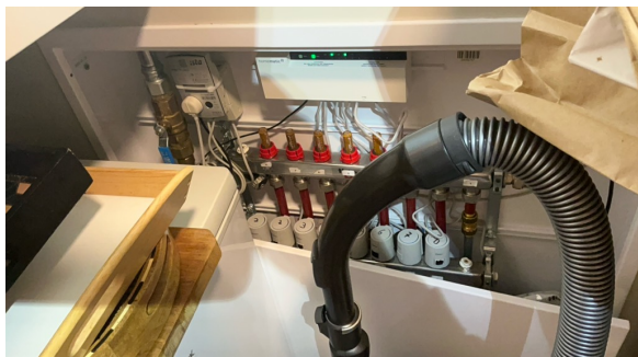
Fordelerskap i teknisk rom.
