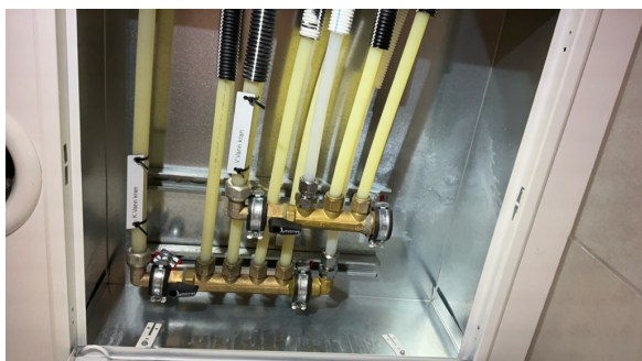
Fordelerskap i himling bad.
