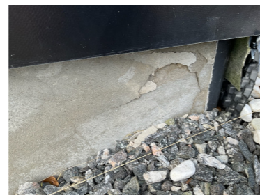
Løsna puss, overgang mot seksjonen over
