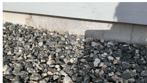
Løsna puss, fra parti mot seksjonen ved siden av
