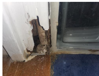
Utført kontroll i tilliggende konstruksjon - Fuktskade ved dør
