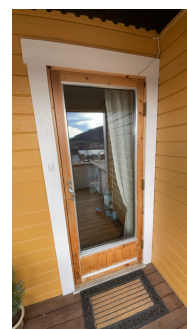
Balkongdør blir brukt som hoveddør.
