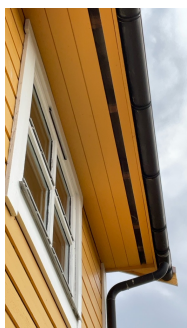
Synlig luftespalte i raftekasse ved overgang tak/vegg
