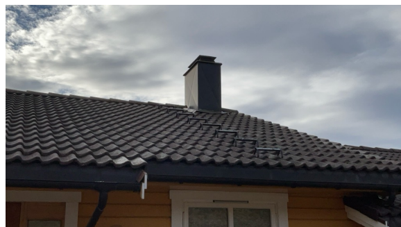
Takstigen er ikke montert i henhold til gjeldende krav
