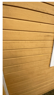
Noe svertesopp og sprekker i kledning på framvegg soverom.
