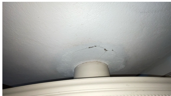
Sprekk i pipe rundt røykrør
