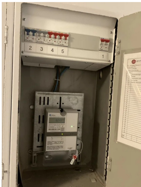
Sikringskap plassert i felles gang
