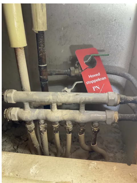
Hovedstoppekran med synlig merking
