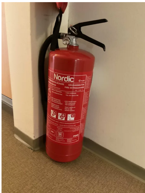
Brannslukningsapparat plassert i gang
