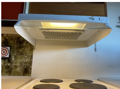
Ventilator over koketopp, komfyrvakt er ikke montert
