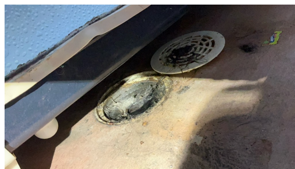
Kontroll av sluk. Ikke rengjort sluk begrenser inspeksjonen.
