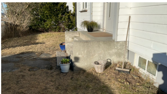
Manglende rekkverk på utvendige trapper.
