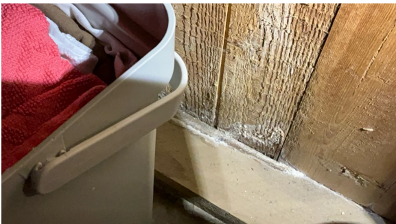
Synlig soppdannelse i delevegg kjeller. Forholdet gis tilstandsgrad 3.
