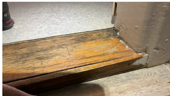
Fuktmerker på dørterskel.
