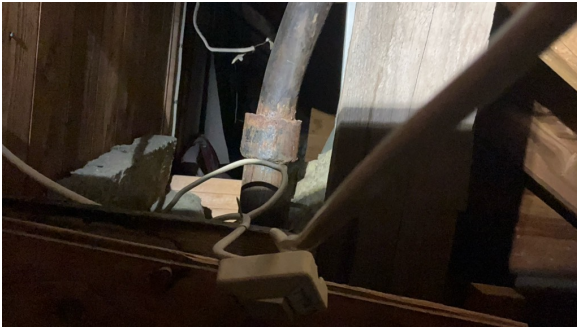
Lufterørene på kott har rustskader.
