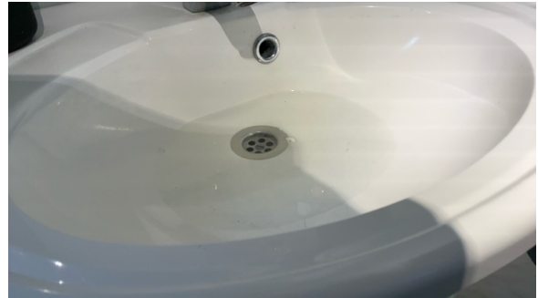
Dårlig avrenning på avløp i servant .
