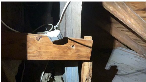
Løse ledninger og bryter i kott.
