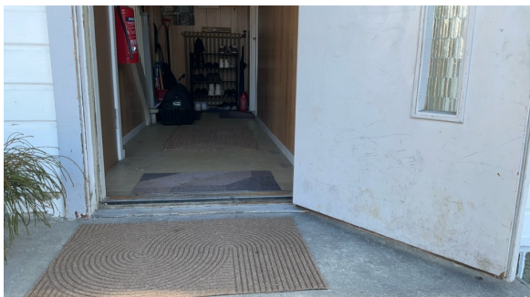
Inngangsdør bærer preg av slitasje. Enkelte skader på døren.
