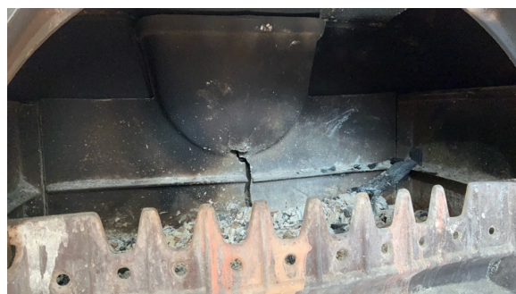
Sprekk i ildfast plate inni ildsted.
