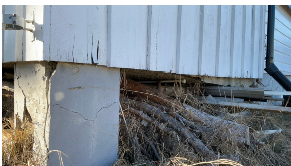
Svikt i betongdekket.
