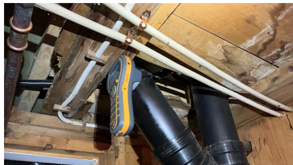
Synlige fuktmerker i etasjeskiller under bad. Fuktmåling viste tørre verdier. Sannsynligvis en eldre lekkasje. Dette må sees i sammenheng med våtrom i rapporten.
