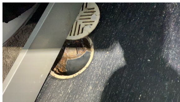
Kontroll av sluk, synlig rustdannelse i sluk.
