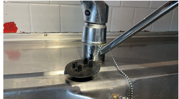
Lekkasje på kran under bruk.
