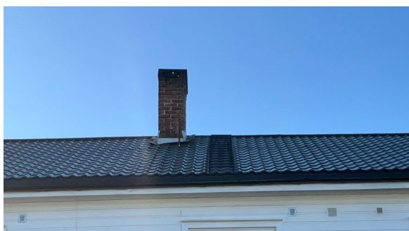
Deformasjoner på pipebeslag sett fra bakkenivå
