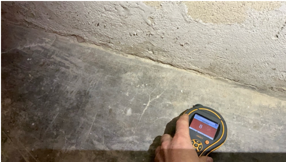
Fuktsøk på gulv og vegg viste forhøyde verdier.
