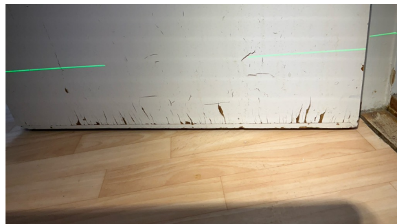
Enkelte dører bærer preg av slitasje.
