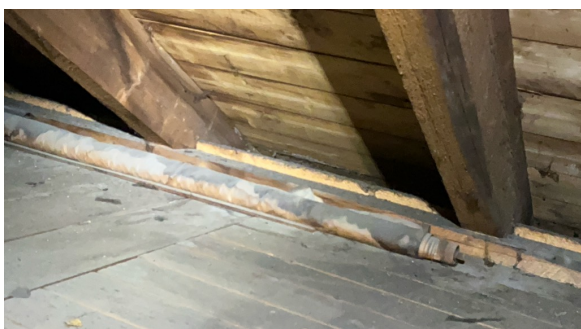
Misfarging og soppdannelser mot raft.
