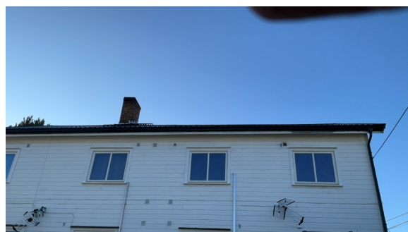
Noe skjevheter/svai i takflaten sett fra bakkenivå.
