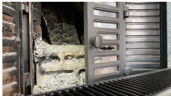
Sprukket glass, sprekker i ildfast stein.
