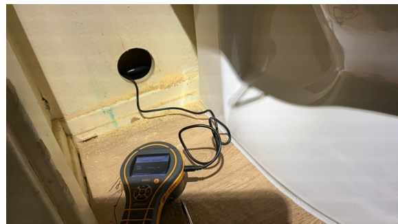
Hulltaking er utført i tilstøtende vegg mot dusjkabinett. Fuktmåling viste tørre verdier.
