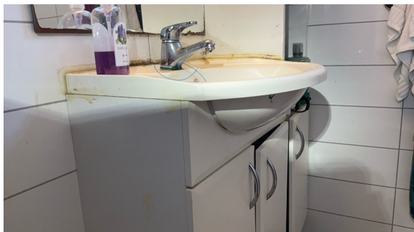
Svelleskader og misfarging på overflater. Ufagmessig utførelse.
