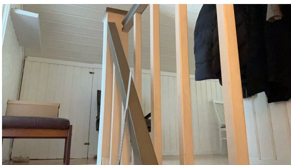
Rekkverkene er lavere enn dagens krav tilsier. Store åpninger i rekkverk.
