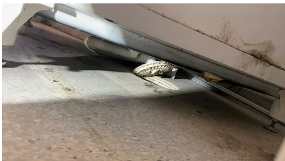
Dusjkabinett er delvis skjøvet frem, sluk er ikke tilstrekkelig innsisert.
