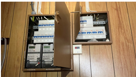
Sikringsskap i 2. etasje. Utette sikringsskap.
