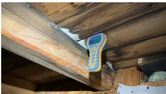
Synlige soppdannelser i undertak kott. Fuktmåling viste tørre verdier. Skadene kan være forårsaket fra før takteking ble skiftet.
