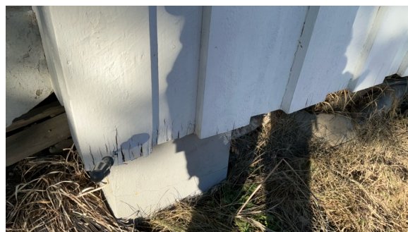
Råteskader registrert flere steder.
