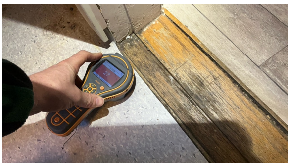
Enkle fuktsøk i området foran dør viste forhøyede verdier. Dette indikerer fuktinntregning.
