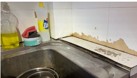
Fuktskader på benkeplater. Avskalling på fliser.
