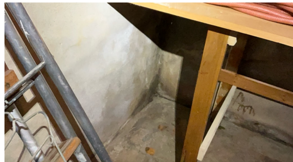
Saltutslag og fuktskjolder flere steder.
