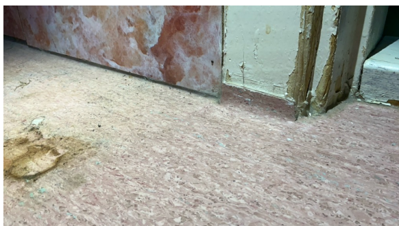
Våtromsplater er lagt ned mot gulvbelegg og fuget. Dette er ikke i henhold til monteringsanvisninger. Det er usikkert om løsningen er tett.
