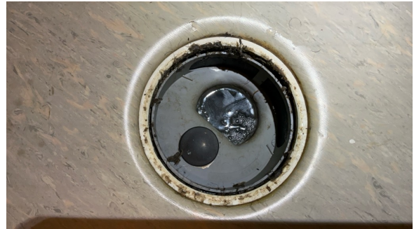
Kontroll av sluk, skade på belegget på sluk.
