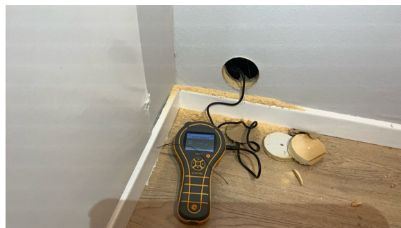
Hulltaking er utført i tilstøtende vegg mot dusjkabinett, fukmåling viste tørre verdier.
