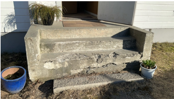
Sprekker og avskalling på betongtrapp.
