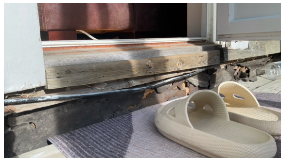
Manglende beslag under verandadør.
