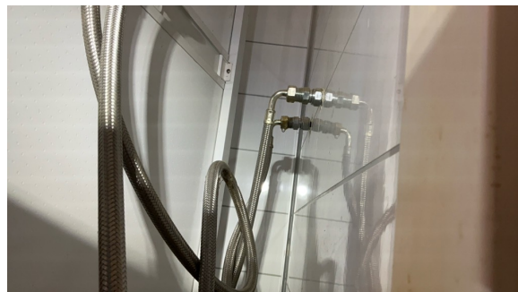
Drypplekkasje fra vannrør bak dusjkabinett. Forholdet gis tilstandsgrad 3.
