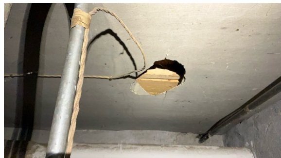
Deler av himling i kjeller kan inneholde asbest. Dette anbefales undersøkt.
