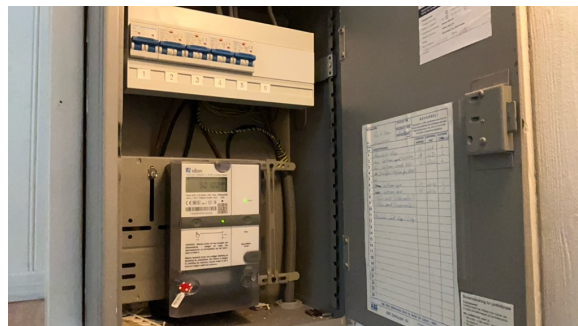
Sikringsskap ved trapp loftsetasje.
