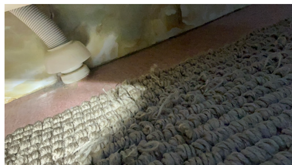
Skade i belegg ved gjennomføring gulv.
