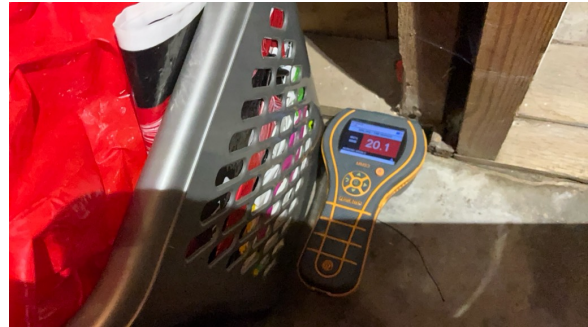
Treverk tilsøtende betonggulv har fuktmerker flere steder. Fuktmålinger viste skadelige verdier med tanke på utvikling av fuktskader.
