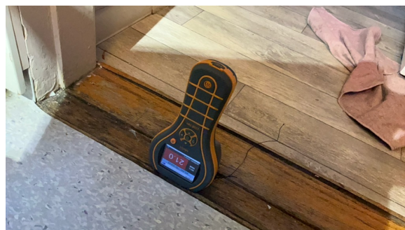
Fuktmåling i dørterskel viste skadelige verdier.
