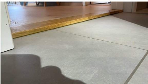
Manglende oppbrett med vanntett sjikt ved dør.
