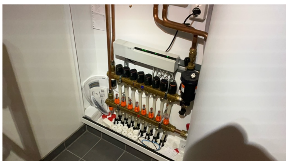
Vannfordelere i bod.
