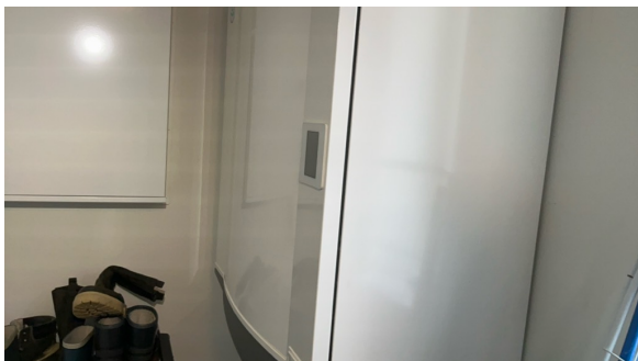
Ventilasjonsanlegg i bod.
