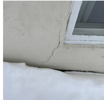
Eksempel på sprekk i grunnmur/kjellervegg.
