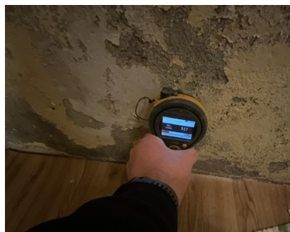
Fuktsøk mot mur underterreng, ned mot gulv. Viser et forhøyet fuktinnhold i mur.
