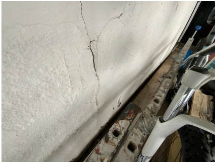
Eksempel på sprekk i grunnmur/kjellervegg
