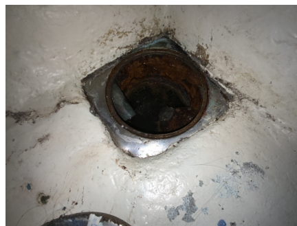
Sluk på dusjrom av støpejern.
