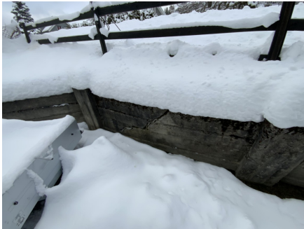
Sprekkdannelse i mur.
