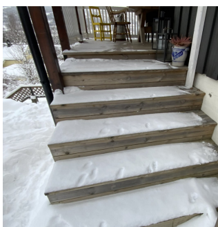
Utvendig trapp mangler rekkverk.
