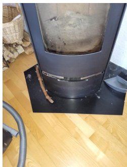
Ildsteder - Ikke tilstrekkelig ubrennbar plate foran ildsted.
