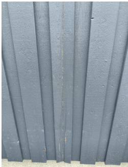
Ytterkledning (fasademateriale, vannbord, utvendig listverk, o.l.) - Skade i kledning
