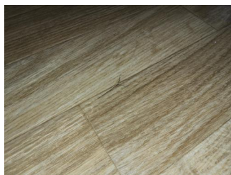
Overflate gulv - Hakk i gulv
