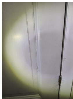
Innerdører - Skade i dør
