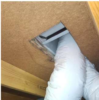
Synlige overflater (taktro, vegger, gulv, o.l) - Eksempel på åpninger i undertak ved takgjennomføring
