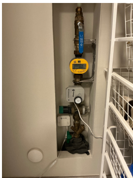
Inntak med stoppekran på vaskerom.
