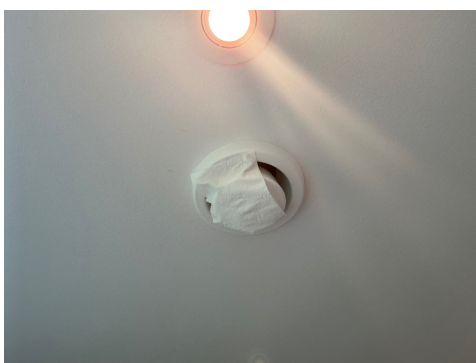
Test av avtrekk. Papiret henger.
