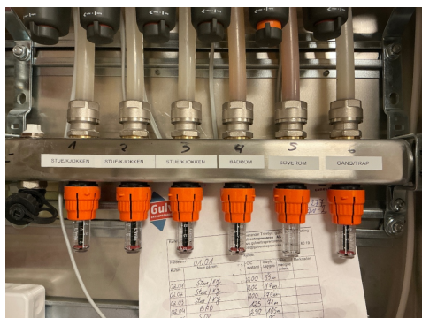
Merkede kurser til den vannbårne gulvvarmen.
