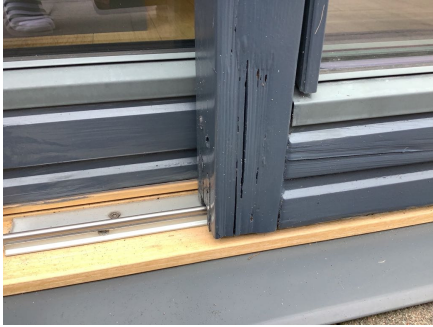
Råteskade på skyvedør
