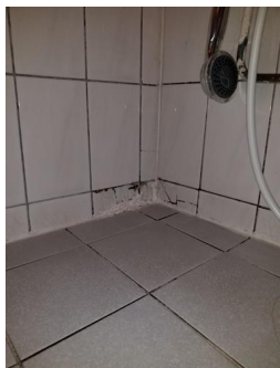
Overflater vegger - Sprekker fliser
