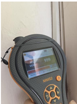
Vinduer og omramming - Fuktmerker vinduskarm soverom.
