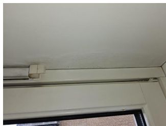
Vinduer og omramming - Fuktmerker vinduskarm stue/kjøkken.
