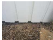
Ytterkledning (fasademateriale, vannbord, utvendig listverk, o.l.) - Kledning kort avstand til terreng
