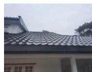
Snøfangere - Manglende snøfangerutstyr
