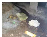
Tilsig av vann og fuktsperre mot grunn - Tilsig av fukt
