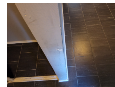
Div skader i leiligheten
