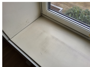
Skader på foringer, lister og vindu
