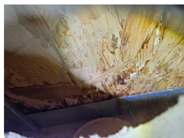
Synlig fukt skjolder i veg bak dusjen
