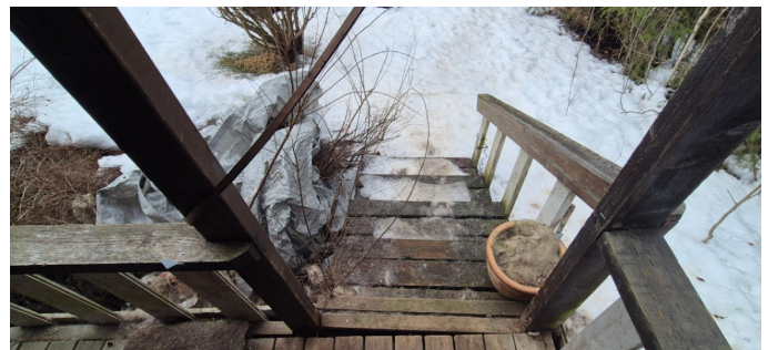
Trapp med mangelfullt rekkverk.
