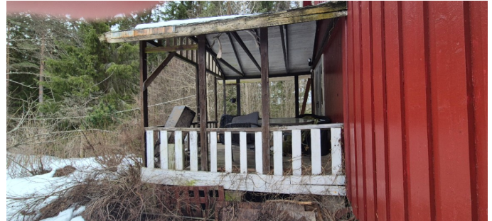
Lavt rekkverk med for store åpninger på veranda
