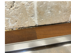
Mangler litt fugemasse/silicon i mellom benkeplate og fliser.
