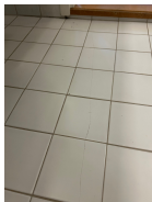
Det ble registrert store sprekker i gulvet
