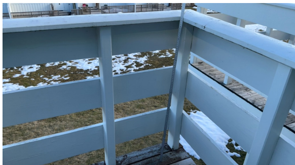
Rekkverk på veranda er for lavt sammenlignet med dagens krav.
