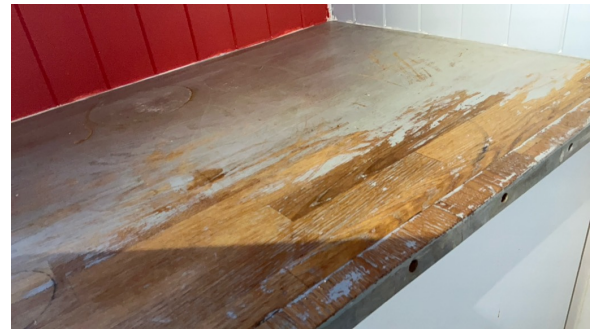
Slitt og ufagmessig overflatebehandling.
