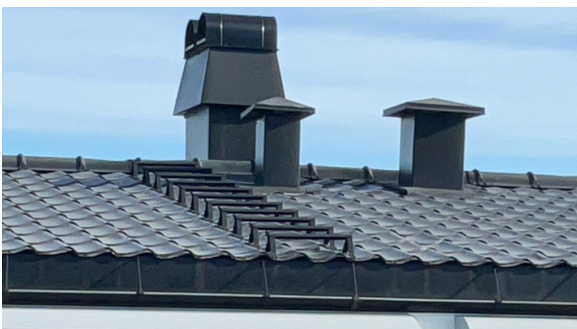
Rust og flass på beslag oppå tak.
