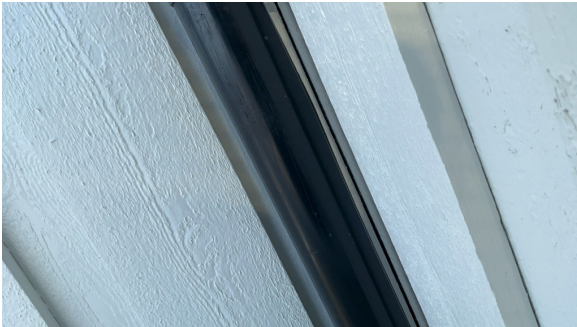
Frostspreng på nedløp.
