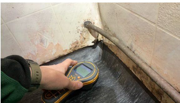
Enkle fuktsøk viste normale verdier. Det er sannsynligvis lenge siden dusj er brukt. Jeg anbefaler ytterligere undersøkelser inni konstruksjonen for å avdekke eventuell skadeomfang og utbedringer.
