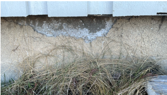
Avskalling på grunnmur.
