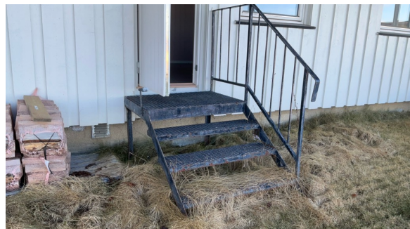
Manglende rekkverk i metalltrapp.
