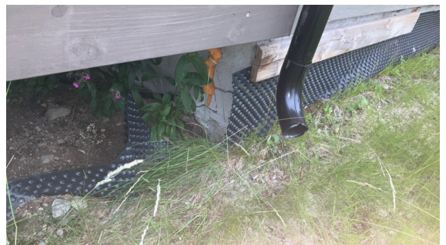
store sprekker i grunnmur mot øst
