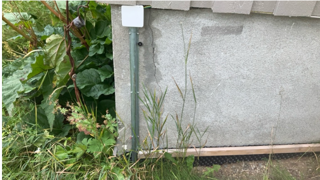
sprekke i grunnmur mot øst
