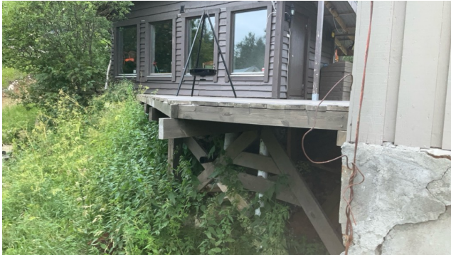
mangler rekkverk på terrasse
