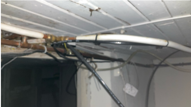
vannledninger en blanding av kobber og plast
