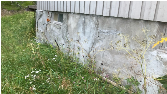
store sprekker i grunnmur mot sør
