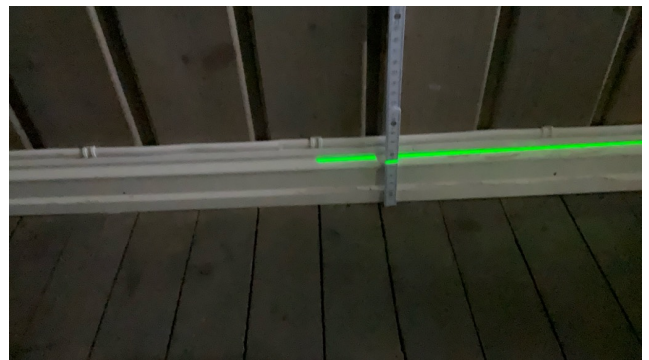
målt skjevheter gulv stue på opp til 6 cm.
