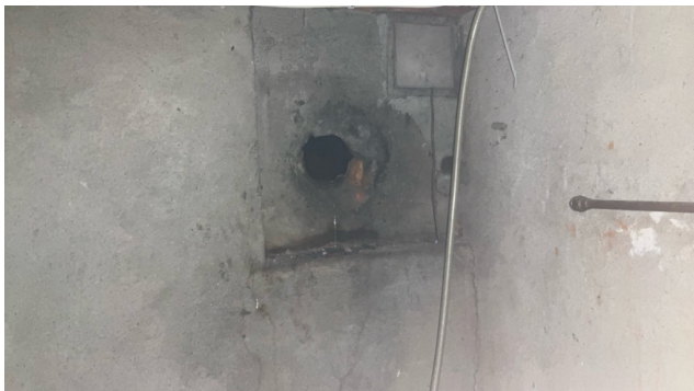
hull i pipe tidligere tilkobling må plomberes.
