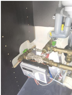
Innvendig stoppekran - Leilighetens stoppekraner
