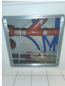
Fordelerskap og fordelerstammer - Fordelerstammer/stoppekraner bad
