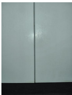
Overflater vegger - Glippe i plateskjøt under dusjarmatur
