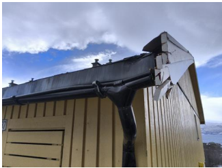
Takrenner og utvendige nedløp - Skade i takrenne og vindski
