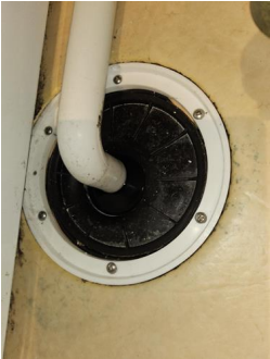
Avløp (inkl. sluk) - Sluk vaskerom.
