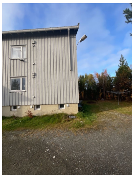
Deler av nedløp mangler på hjørne mot innkjøring og parkering.
