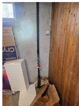
Vanninntak og stoppekran i kjeller
