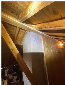
Fuktflekker på taksperrer rundt pipe 1.
