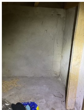
Sprekke i vegg i bod under trapp
