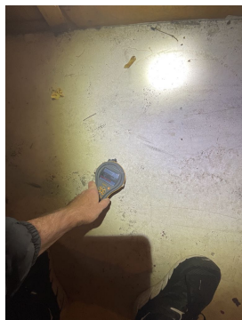
Høye utslag på fuktindikasjoner på gulv i kjeller.
