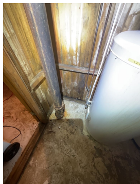
Fukt og råteskader på vegg og tak i bod under kjøkken til 1A
