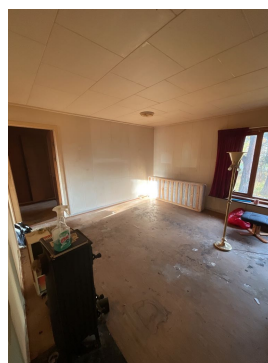
Større skader på innvendige overflater.
