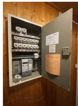
Sikringsskap plassert på vegg i felles trappegang.
