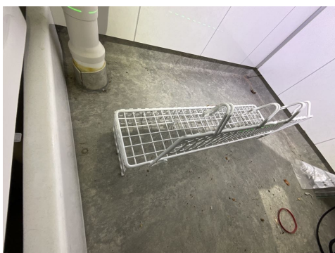
Sprekk i mansjett rundt avløp til vaskemaskin.
