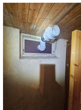
2 stk. avtrekksvifter for radon i kjeller
