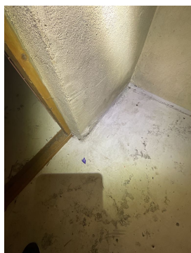
Saltutslag på innvendig betongmur.
