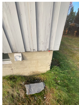
Symptomer på røte på utvendig kledning hjørne mot innkjøring og parkering.
