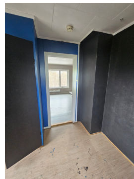
Mye malingsflekker på gulv i soverom
