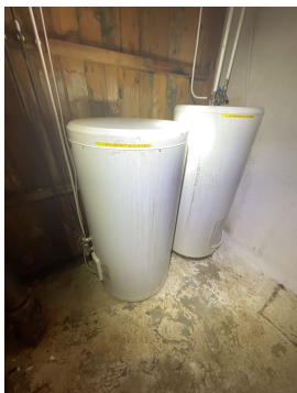
Felles beredere plassert i bod kjeller.
