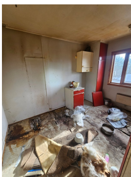
Fukt og råteskader på gulv kjøkken
