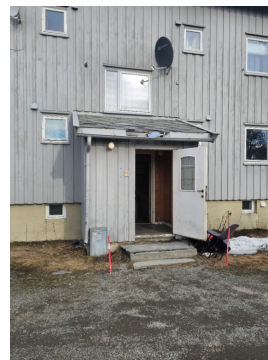
Mangler skiferstein på tak tilbygg.
