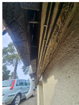
Mangler musestoppere på utvendig klednin
