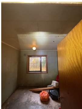
Større skader på innvendige overflater, stygg lukt inne i leilighet spesielt på soverom
