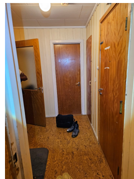
Mye sår og hakk på enkelte innerdører.
