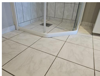
Plassering av sluk og avrenningsmuligheter - Isolert sluk.
