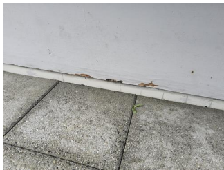
Tilstand på rekkverk og overflatematerialer - Råteskader.
