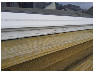
Vinduer og omramming - Slitte overflater.
