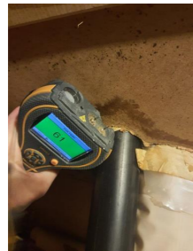
Synlige overflater (takte, vegger, gulv, o.l.) - Fuksøk fuktmerke i tak ved takgjennomføring.
