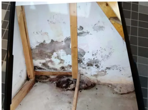
Eksempel på saltutslag/fuktransport i gjennom grunnmur.
