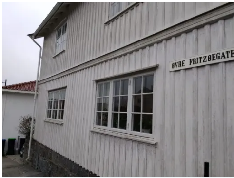
Eksempel på fasade med behov for vedlikehold.
