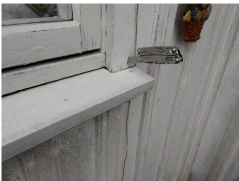
Eksempelet på råteskade.
