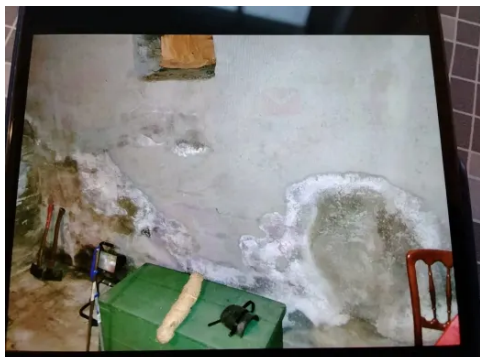
Eksempel på saltutslag/fuktransport i gjennom grunnmur.
