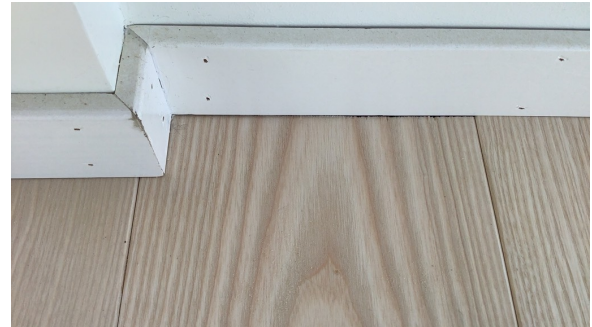
Det er registrert at fotlist ikke dekker helt mot parkettgulv enkelte plasser.
