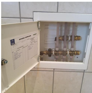
Fordelerskap og fordelerstammer - plassert i vegg på bad
