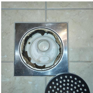
Avløp (inkl. sluk) - Sluk dusjsonen
