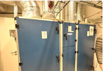
Teknisk rom i Rambergveien 17B.
