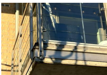
Ubehandlet impregnertrverk i front av balkonggulv.
