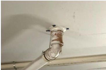
Avløpsrør med synlig brannmansjett.
