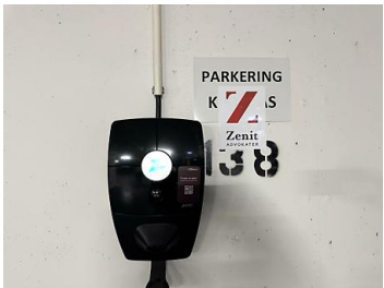
Opplegg for elbillading med elbillader fra Zaptec.
