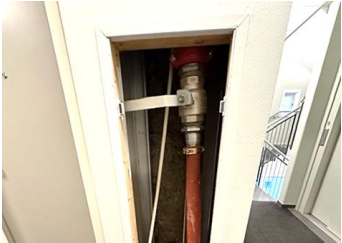
Det er montert brannslanger i fellesganger.
