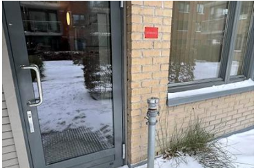
Brannklo utvendig del for brannslukking.
