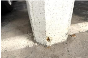
Rust nederst på betongsøyle i nedre parkeringskjeller.
