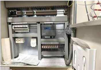
Teknisk rom i Rambergveien 17B.
