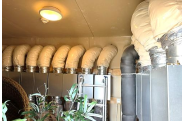
Ventilasjon med eget aggregat for hver leilighet.
