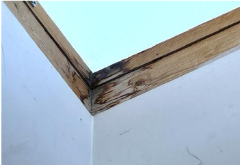
Tegn til lekkasje på takvindu i trappegang (19).
