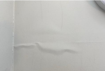
Tegn til fuktnnslag fra yttervegg i trappegang.
