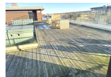
Vedlikeholdsbehov på takterasse Rambergveien 17.
