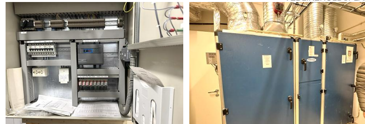
Teknisk rom i Rambergveien 17B.
