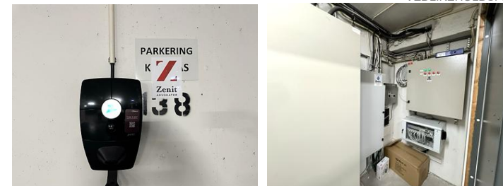
Opplegg for elbillading med elbillader fra Zaptec.
