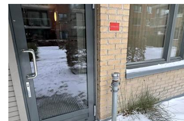
Brannklo utvendig del for brannslukking.
