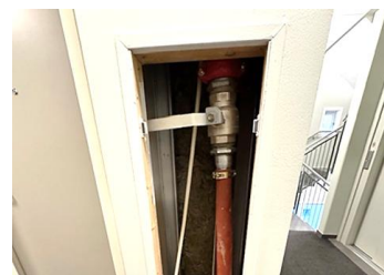
Det er montert brannslanger i fellesgang.
