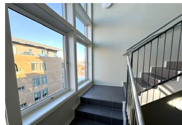
Manglende sikring i trappegang til uteterrassen på tak.
