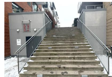
Det er varmekabler i utvendig trapp mot vest.
