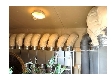
Ventilasjon med eget aggregat for hver leilighet.
