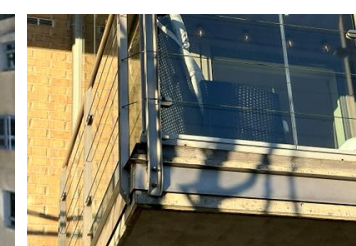
Ubehandlet impregneret treverk i front av balkonggulv.
