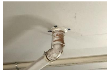
Avløpsrør med synlig brannmansjett.
