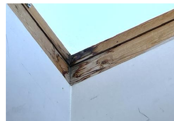
Tegn til lekkasje på takvindu i trappegang (19).
