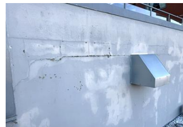
Sprekker i betongvegg ved Kverneriet og litt lekkasje.
