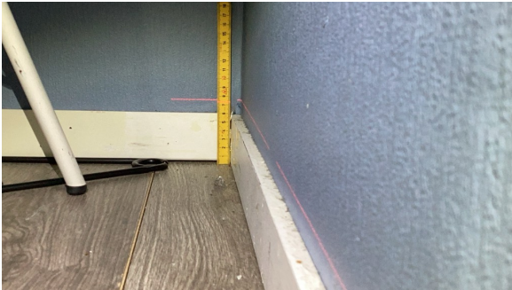
Helningsavvik på 34 mm ble målt på soverom i 1. etasje.
