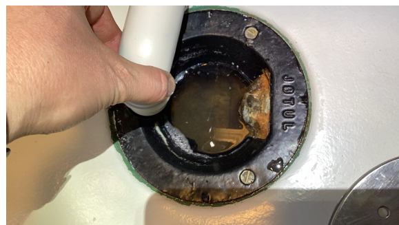
Rust i sluk.
