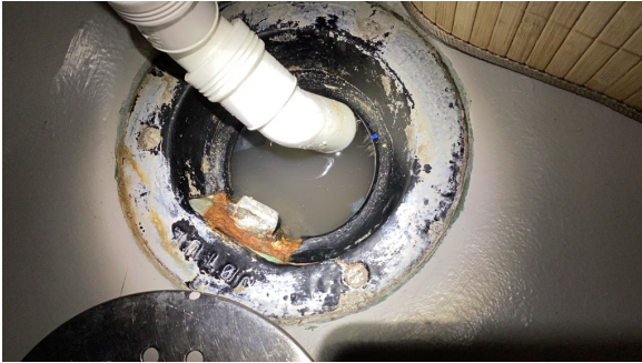
Rust i sluk.
