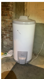
Varmtvannstank i kjeller har ukjent alder.
