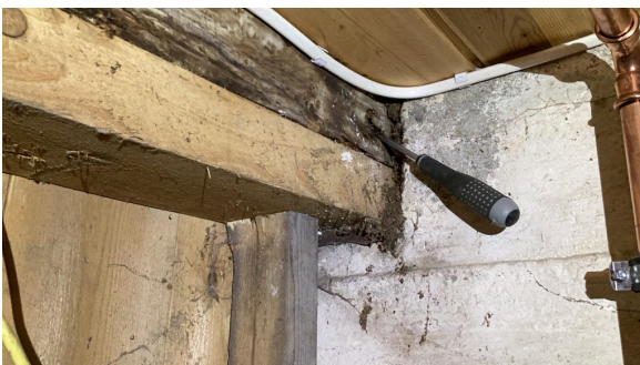
Råte observert i etasjeskille.
