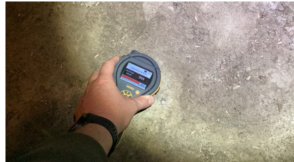
Påvist forhøyede fuktindikasjoner i overflater på betonggulv som er mer eller mindre vanlig på eldre gulv uten fuktsperre og samtidig kan ha en sammenheng med sviktende fuktsikring.
