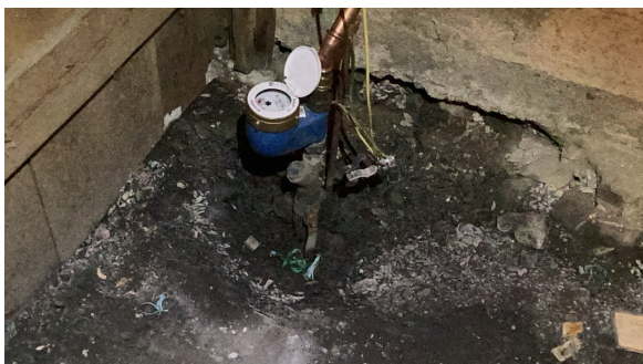
Stoppekran og vannmåler i kjeller. Rust på stoppekran.
