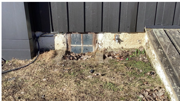
Lav høyde mellom terreng og kjellervinduer.
