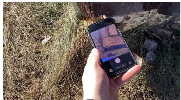
Det er observert åpninger i utvendig komplettering som øker risikoen for at mus kan komme inn.
