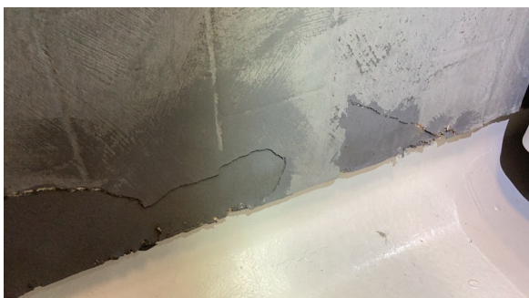
Nederste del av veggplater rundt om har fuktskader.
