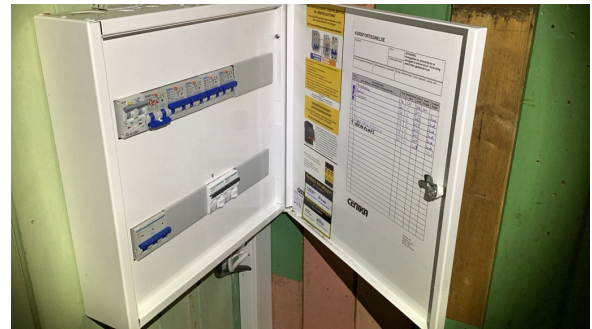
Sikringsskap i trapperom.
