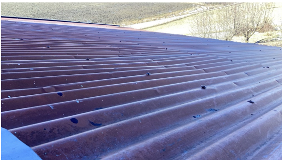
Enkelte bulker på plater, samt spiker som ikke strammer nedtill plater.
