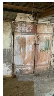
Ytterdør i kjeller bærer preg av slitasje.
