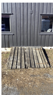
Kjellerlem bør utbedres da denne er ødlagt.
