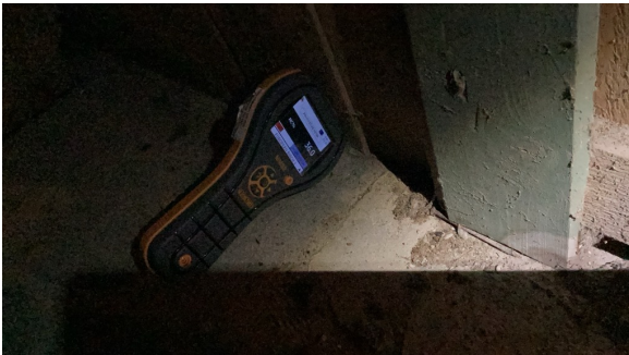
Fuktmåling ble foretatt, jeg målte skadelig fukt.
