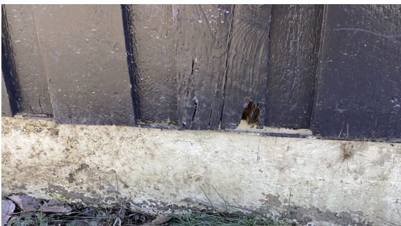
Råte på kledning.
