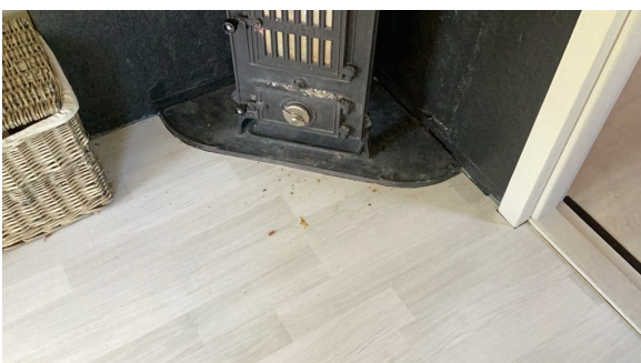
Mangler ubrennbar plate foran ildsted.
