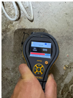
Bilde av fuktsøk i betonggulv i kjeller.
