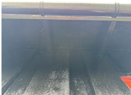
Bilde av ingen luftespalter mellom taksperrer utvendig
