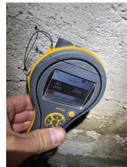
Bilde av fuktsøk i nedkant vegg i kjeller.
