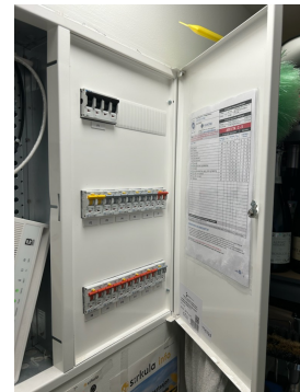
Sikringskap med automatsikringer.
