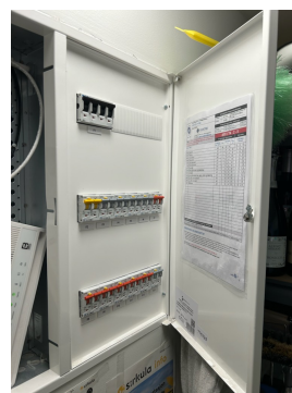
Sikringskap med automatsikringer.
