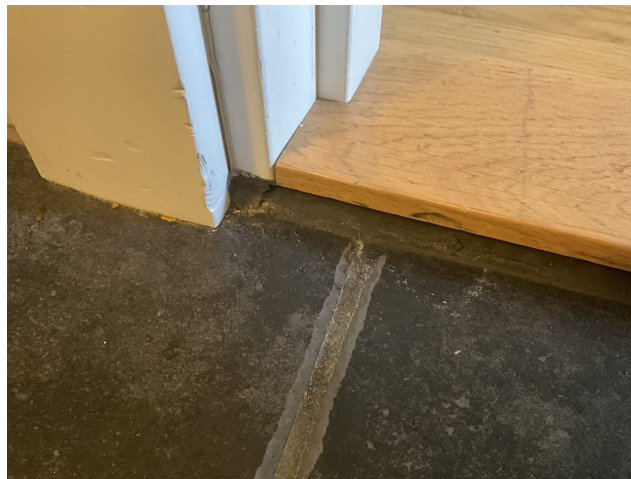
Foto 3: Gulvovergang ved dørterskel. Ingen membranoppkant.
