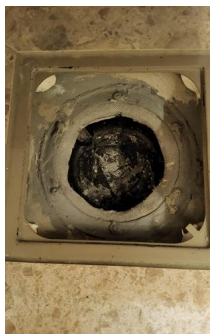
Avløp (inkl. sluk) - Sluk under servant
